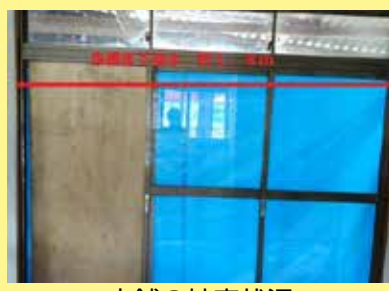
店舗の被害状況
