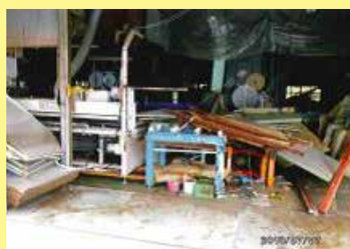
工場の被害状況
