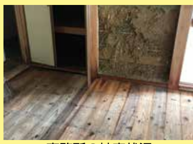
事務所の被害状況
