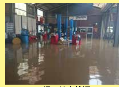
工場の被害状況
